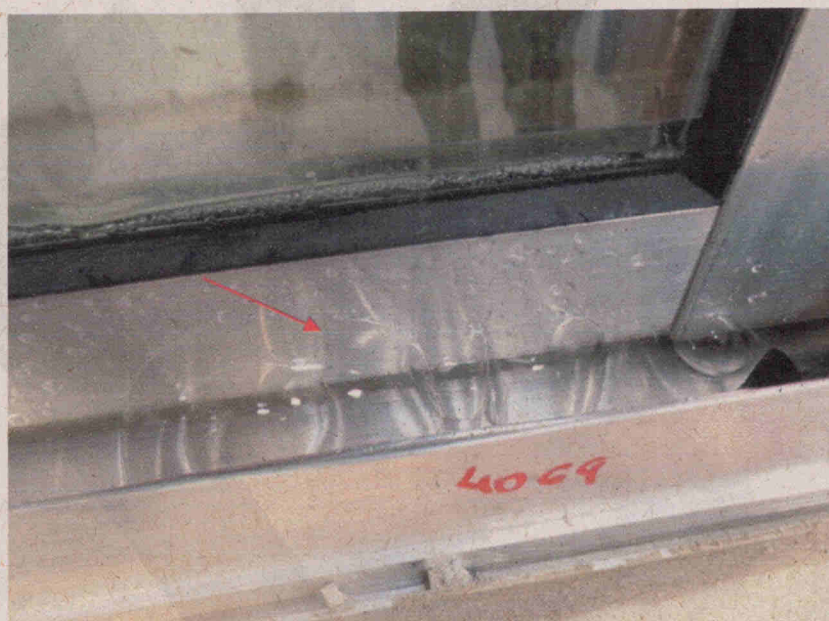
Foto nº. 02 Verificação da estanqueidade à água: PI-01: Borbulho entre a travessa inferior da folha direita e a travessa do marco, sem ocasionar respingos para a face interna (1').
