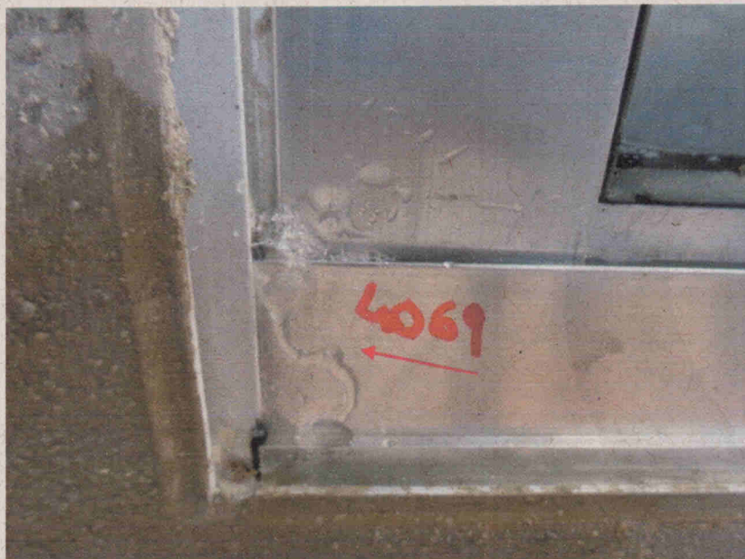
Foto nº. 03 Verificação da estanqueidade à água: PE-02: Transbordamento para a face interna (1').
