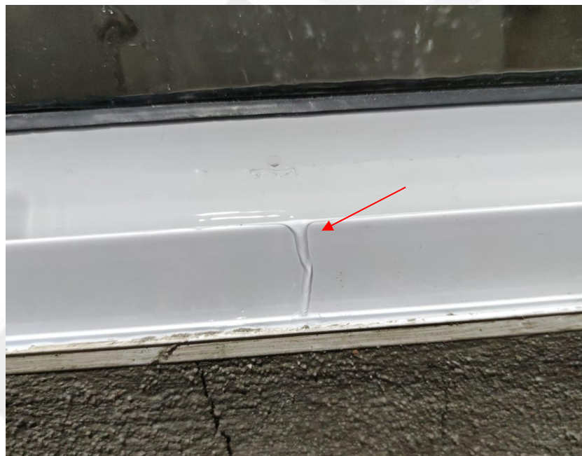
Foto nº. 04 Verificação da estanqueidade à água: PE-01: Transbordamento na travessa inferior do marco, na região central (2').
