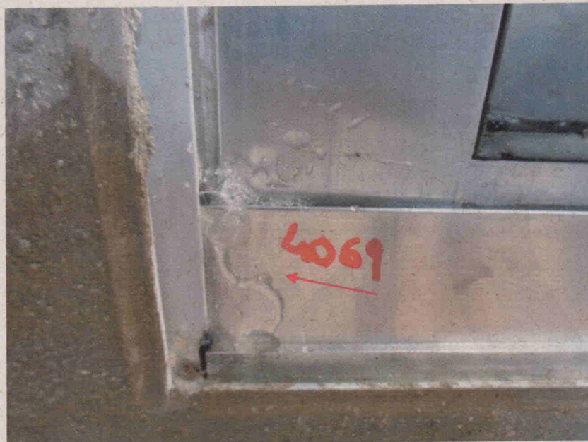
Foto nº. 03 Verificação da estanqueidade à água: PE-02: Transbordamento para a face interna (1').
